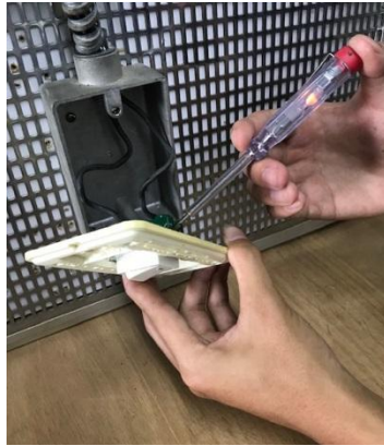
รูปที่ 9.4 การตรวจสอบสายมีไฟ (L) ในสวิตช์โดยใช้ไขควงเช็คไฟ
