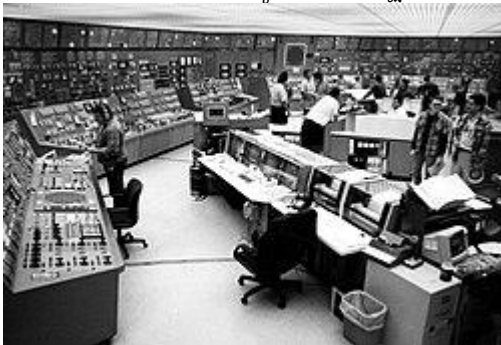
ห้องควบคุมที่โรงไฟฟ้าพลังงานนิวเคลียร์สหรัฐ
