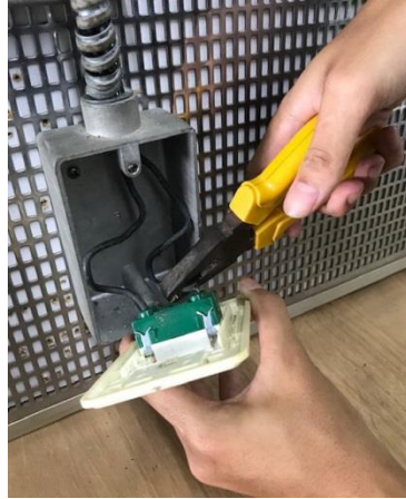
รูปที่ 11.5 การตรวจสอบจุดต่อสวิตช์
