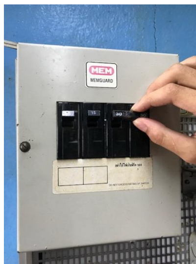
รูปที่ 11.4 การตรวจสอบแผงย่อย
