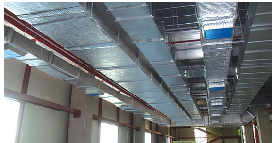
ท่อส่งลม
